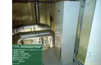
リチウムイオン蓄電池
